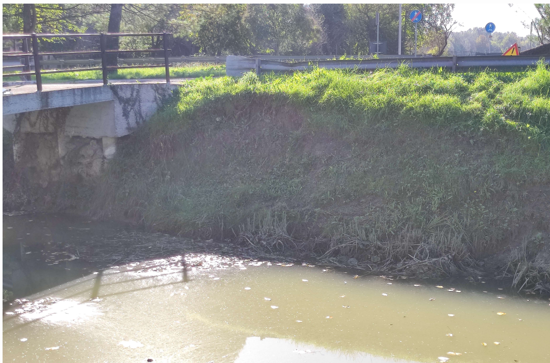
Figura 23. Particolare dell'erosione spondale segnalata come elemento di criticità E-3.1.
