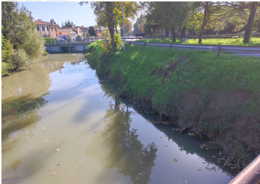
Figura 24. Particolare dell'erosione spondale segnalata come elemento di criticità E-3.2.
