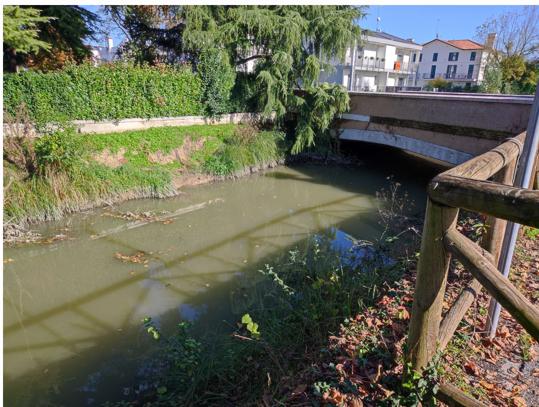
Figura 21. Particolare dell'erosione spondale segnalata come elemento di criticità E-2.3.
