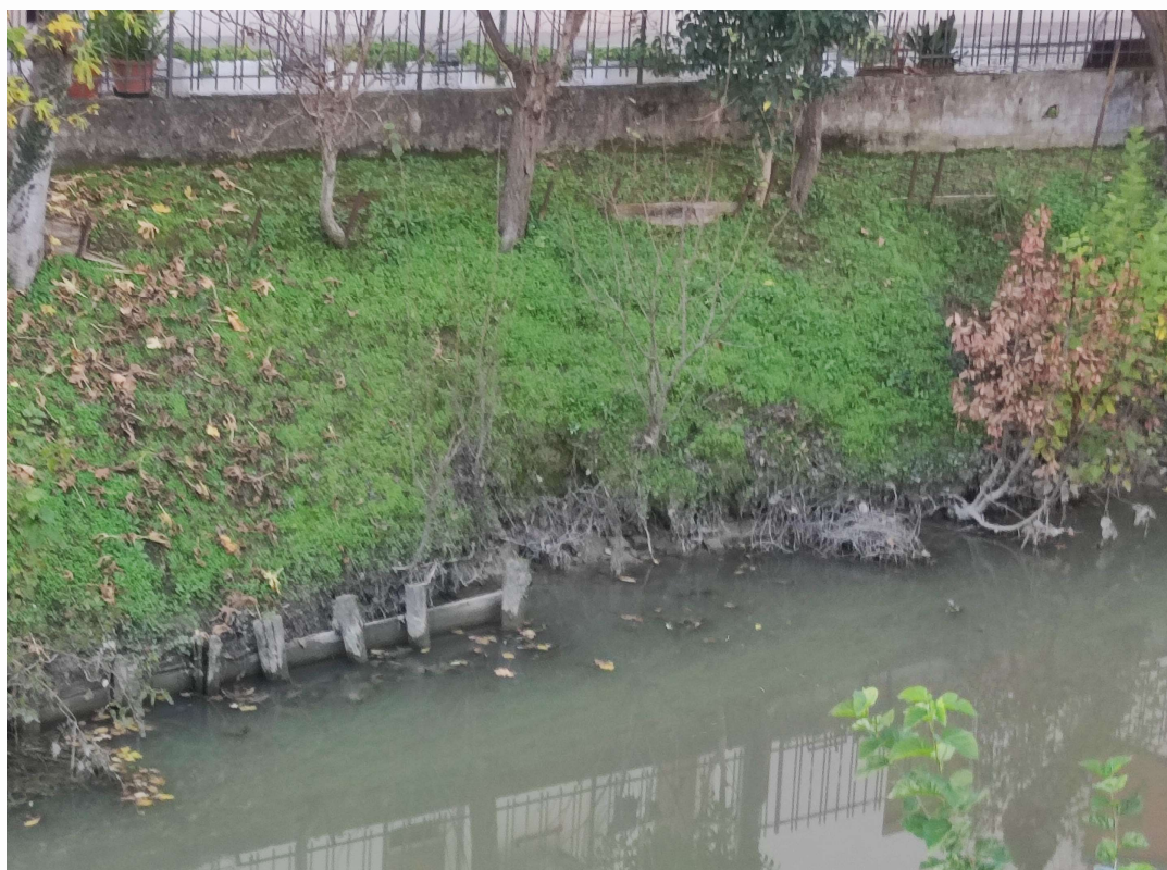
Figura 17. Particolare dell'erosione spondale segnalata come elemento di criticità E-1.3.
