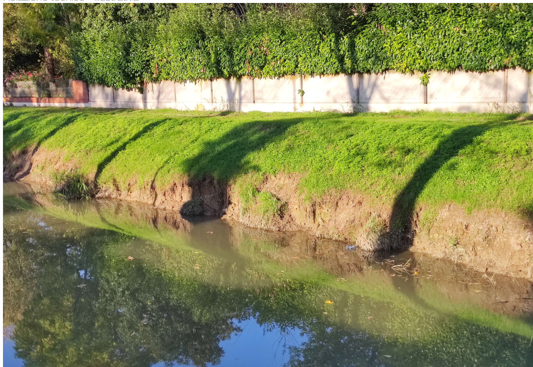
Figura 20. Particolare dell'erosione spondale segnalata come elemento di criticità E-2.2.
