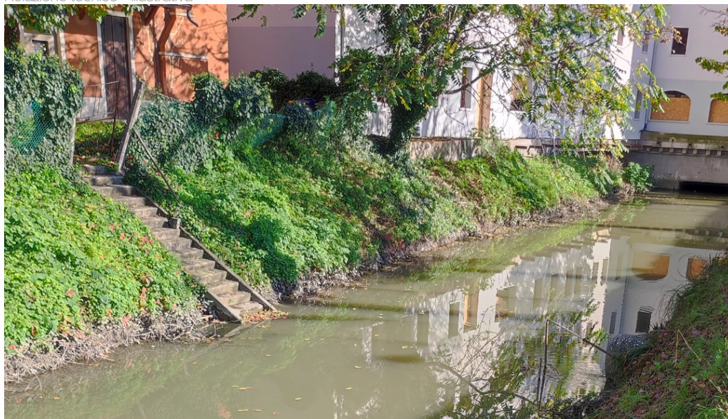
Figura 29. Veduta di una scala di accesso all'alveo. Si può notare un principio di erosione al piede della struttura.
